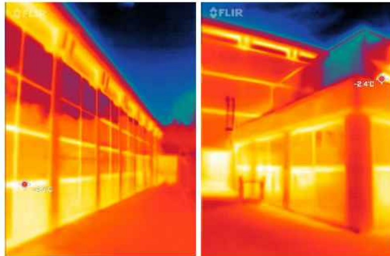
Abbildung 19: Thermografie des Hallenbades auf der Ostseite (links) und auf der Südseite (rechts)
